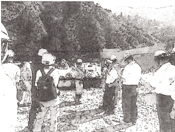
南股上流の砂防工事現場、人里離れた現場で携わる関係者の安全を願うばかりだ
